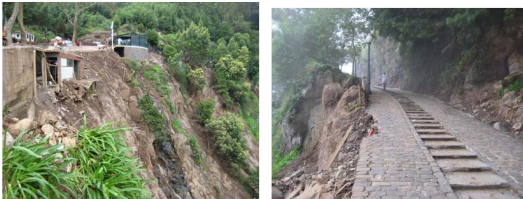
Figura 35 - Exemplo das ocorrências verificadas na Zona 3
