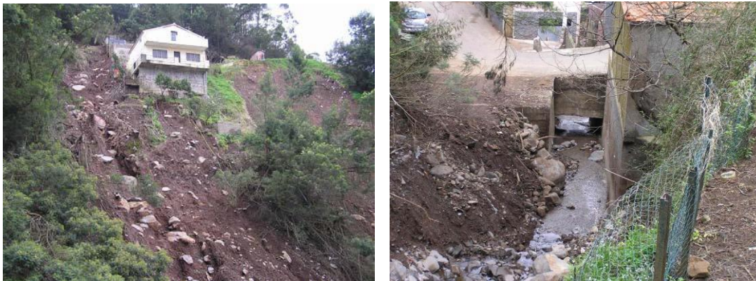
Figura 34 - Exemplo das ocorrências verificadas na Zona 2
