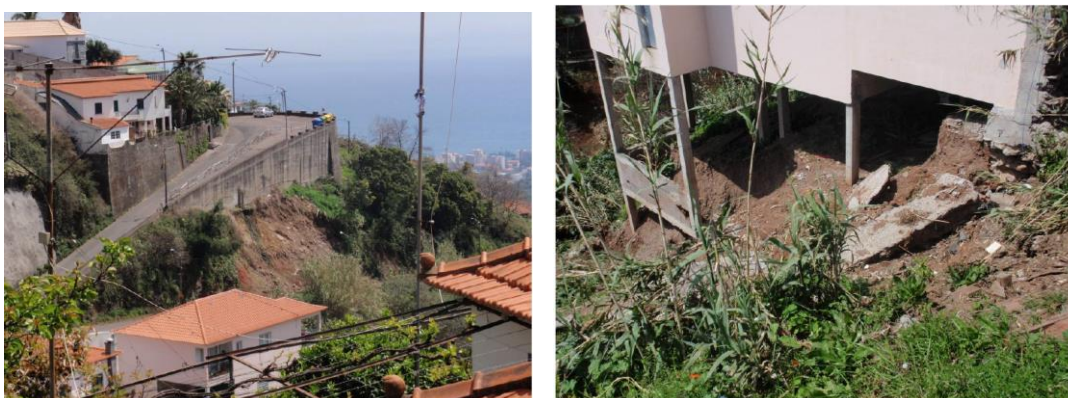
Figura 38 - Exemplo das ocorrências verificadas na Zona 6
